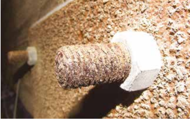
Galvanik korozyon örnekleri Galvanic corrosion examples
