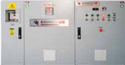
Yüksek kapasiteli kontrol paneli.
